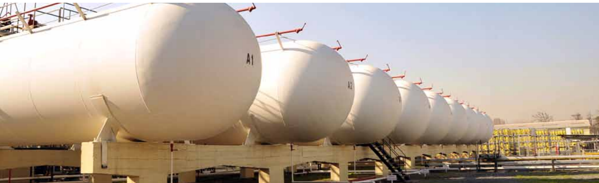
Foto: Estanques almacenamiento Planta Maipú
