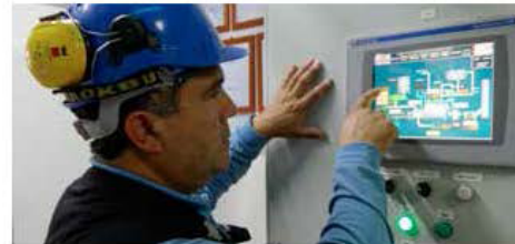
DAGOBERTO RUZ OPERANDO EL SISTEMA DE GENERACIÓN DE VAPOR CON BIOMASA A TRAVÉS DE LA PANTALLA TÁCTIL.
